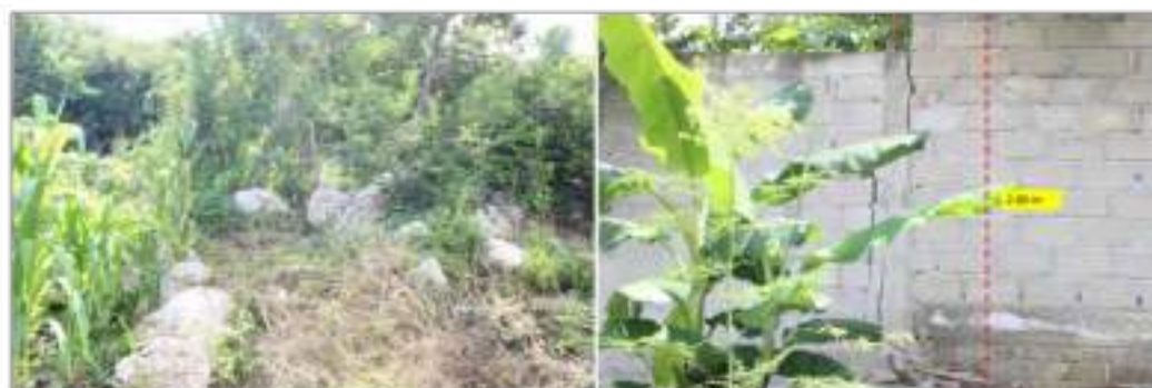
Fotografía 220 (izq.). Se observan caídos de rocas calizas. Fotografía 221. (der.). Procesos constructivos deficientes en barda de vivienda.
