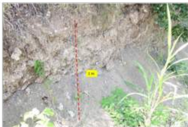
Fotografía 222. Corte de talud de un metro de altura sobre vialidad de terracería en Loma Bonita, Terán.
