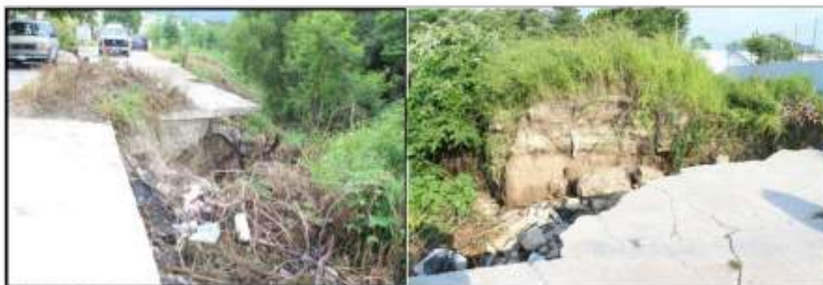
Fotografías 138 y 139. Dos vistas del mismo punto (481320, 1846430 UTM) vialidad afectada por la erosión.
