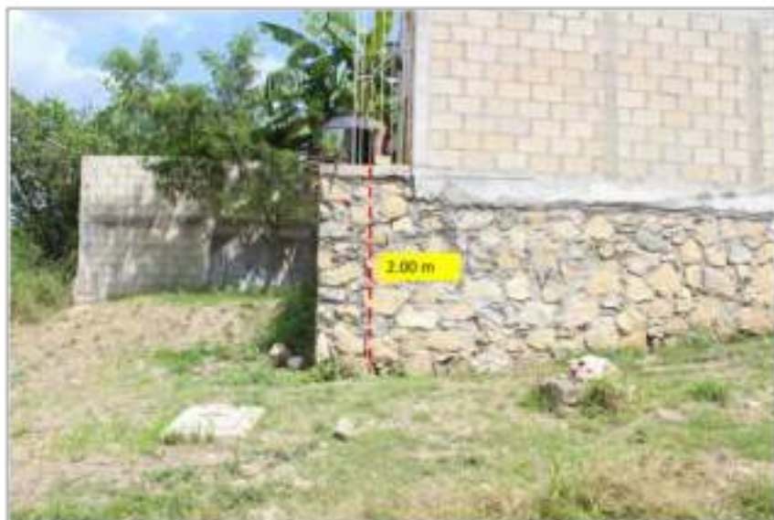
Fotografía 218. Fractura en muro de contención en vivienda ubicada en la colonia Nuevo Amanecer de Sábines.
