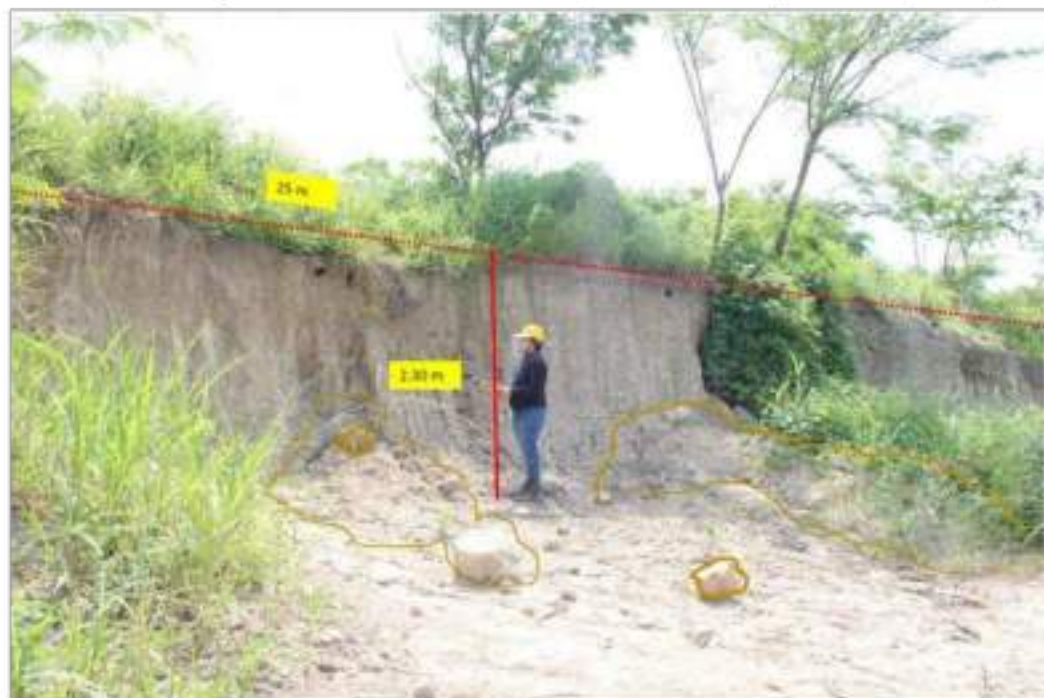
Fotografía 153. Área verde colindante con el fraccionamiento Chiapas Bicentenario, con presencia de caídos y derrumbes de material no consolidado.
