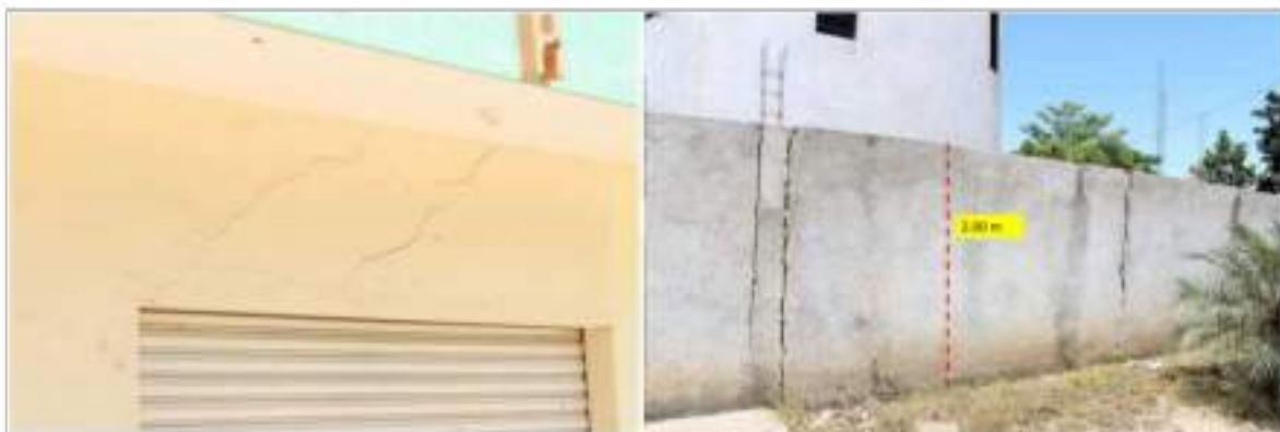
Fotografía 198 (izq.). Punto de control (482203, 1848628 UTM) grietas cortantes de 45^\circ por asentamientos. Fotografía 199 (der.). Punto de control (482213, 1848714 UTM) separación de castillo por proceso constructivo deficiente.
