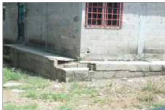
Fotografía 160. Banqueta fracturada en colonia Montecristo.
