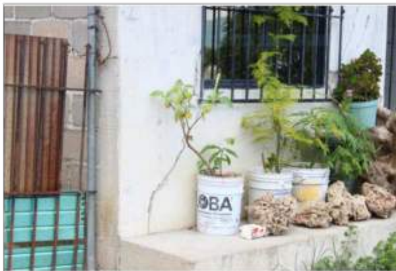
Fotografía 212. Vivienda de autoconstrucción con datos de pared dañada en Loma Bonita, Terán.
