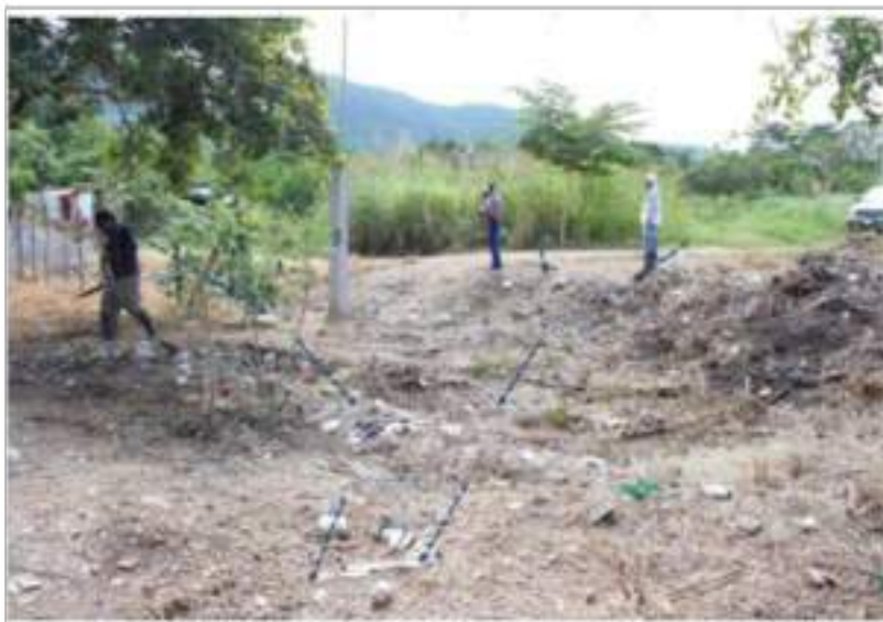
Fotografía 46. El cauce natural ha sido modificado con material de relleno para construir una vialidad de terracería.
