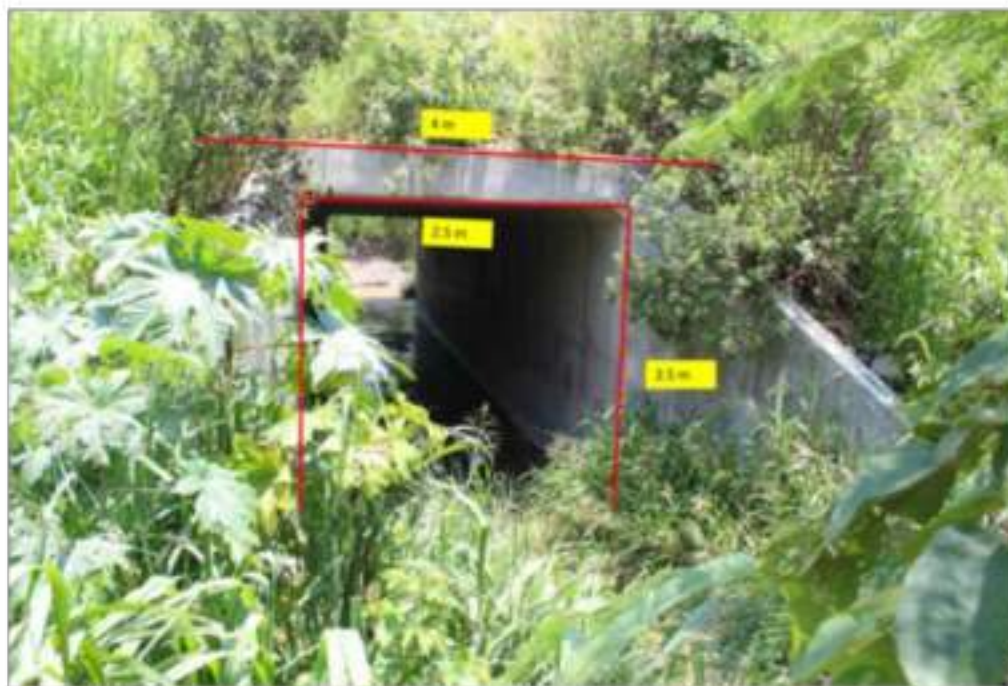
Fotografía 57. Puente cuadrangular con aguas residuales.
