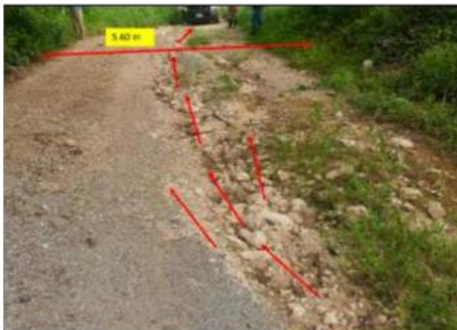
Fotografía 13. Vialidad en donde fluye en forma laminar el arroyo intermitente.
