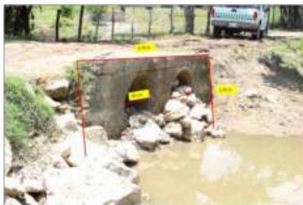
Fotografía 111. Tubos de concreto azolvados (477483, 1848808 UTM).
