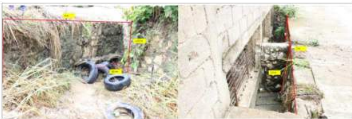
Fotografía 76 (izq.). Se muestran las condiciones del puente azolvado en la vialidad que colinda con las bodegas de CERAMAT (punto de control 7). Fotografía 77 (der.). Puente con pila intermedia que atraviesa propiedad privada delimitada con barda.
