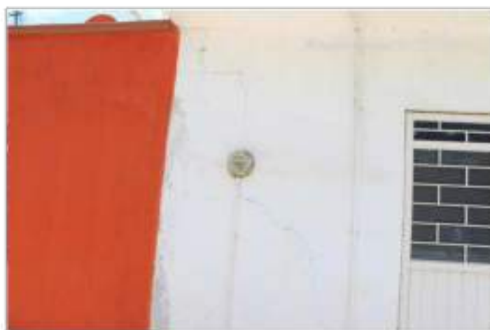
Fotografía 200. Punto de control 14; vivienda con registro de agrietamientos.
