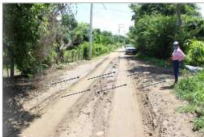
Fotografía 103. Vialidad en San José Terán que modificó el escurrimiento intermitente.
