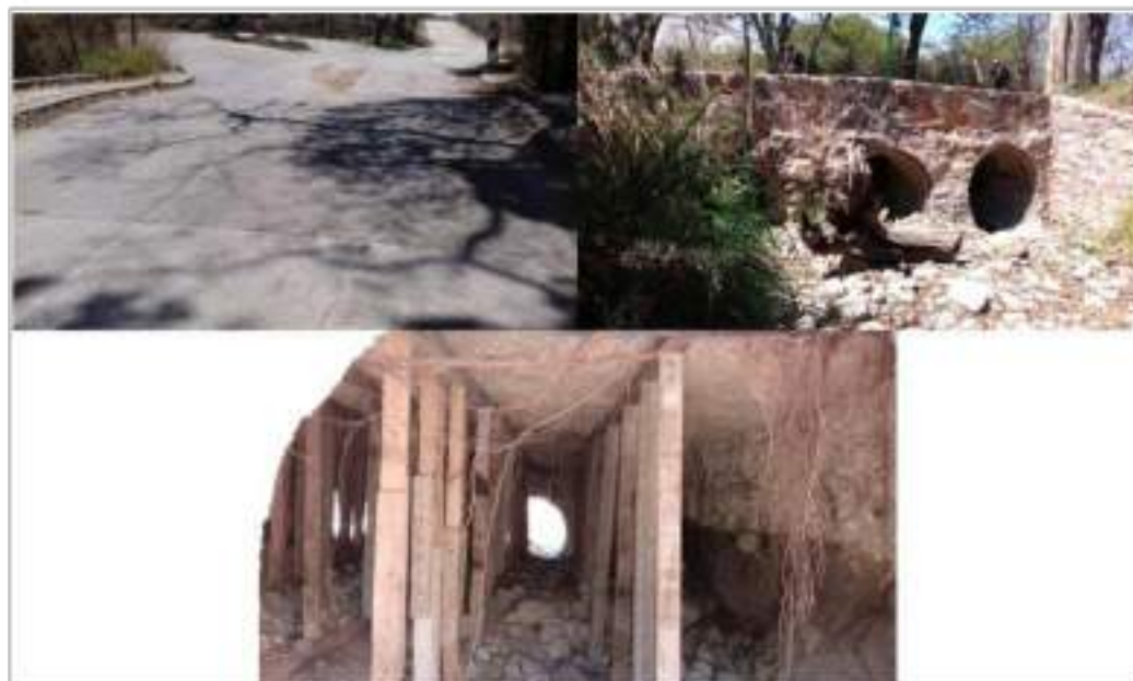
Fotografía 1 (arriba, izq.). Puente camino a Chiapas Bicentenario en 2017. Puede observarse el tramo de vialidad dañada. Fotografía 2 (arriba der.). Se observa el colapso de los tubos hidráulicos. Fotografía 3 (abajo). Apuntalado, deficiente, para reducir riesgo de colapso.
