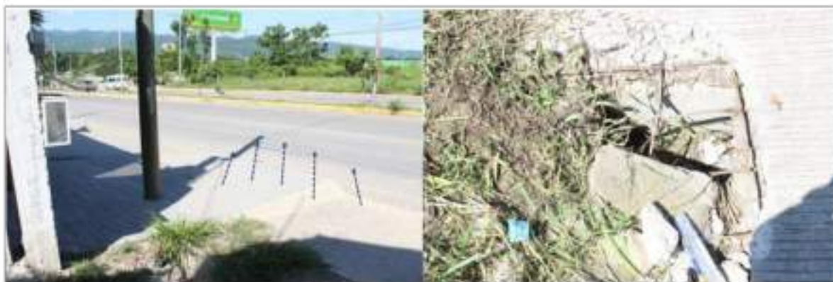
Fotografía 92 (izq.). Esguimiento natural modificado por la construcción de viviendas, que distribuyen el esguimiento de forma laminar sobre vialidad. Fotografía 93 (der.). Corresponde a alcantarilla dañada en la principal avenida de la zona de crecimiento.
