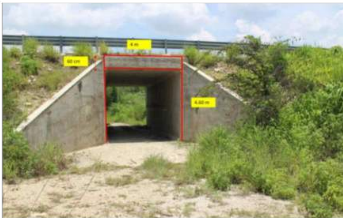
Fotografía 59. Puente cuadrangular que da paso al escurrimiento de norte a sur, atravesando el Nuevo Libramiento Sur.
