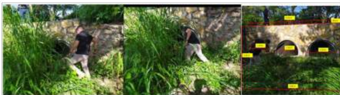
Fotografías 9 y 10 (izq. y centro). Condiciones del puente en el punto 22 (UTM 482674, 184588). El puente bloquea el flujo del agua del cauce del arroyo. Fotografía 11 (der.). Se muestran las medidas del puente y de los tubos por los que ahora debe fluir el agua.
