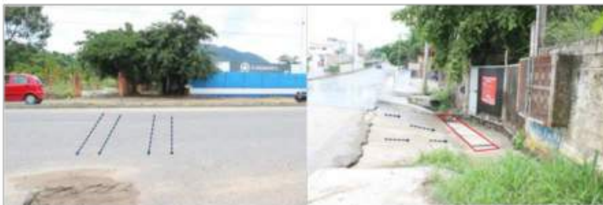
Fotografía 60 (izq.). Calzada Emiliano Zapata, presenta encharcamientos por escurrimientos pluviales debido a que las construcciones desviaron el cauce natural. Fotografía 61 (der.). Alcantarilla pluvial erosionada por escurrimientos pluviales.
