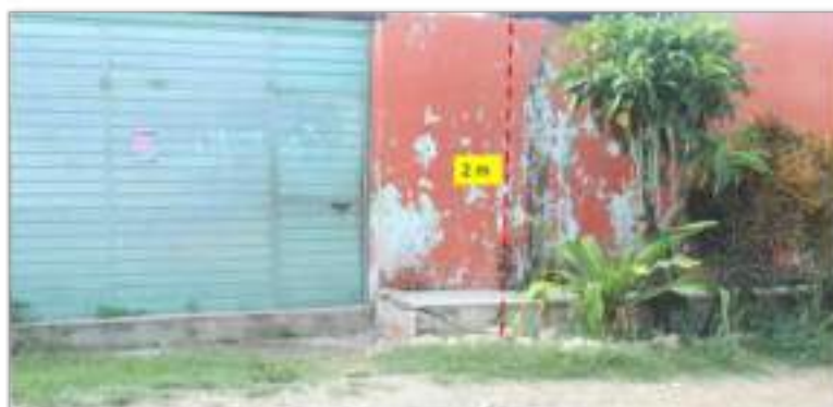
Fotografía 158. Colonia CCI, Camino a Rancho Viejo, vivienda con fractura en barda y daños en banqueta.
