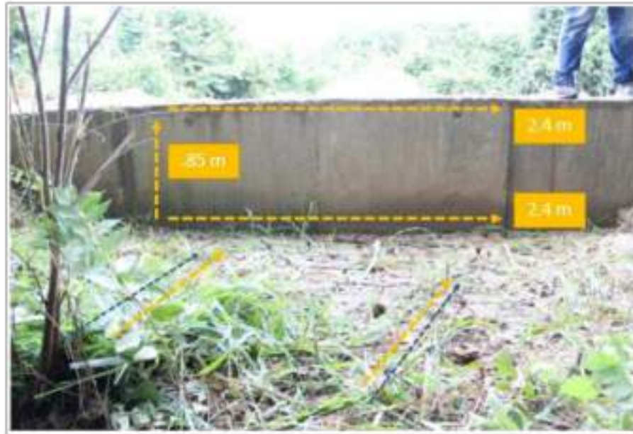
Fotografía 48. Azolvamiento de material pétreo en muro sobre camino rural a Pacú.
