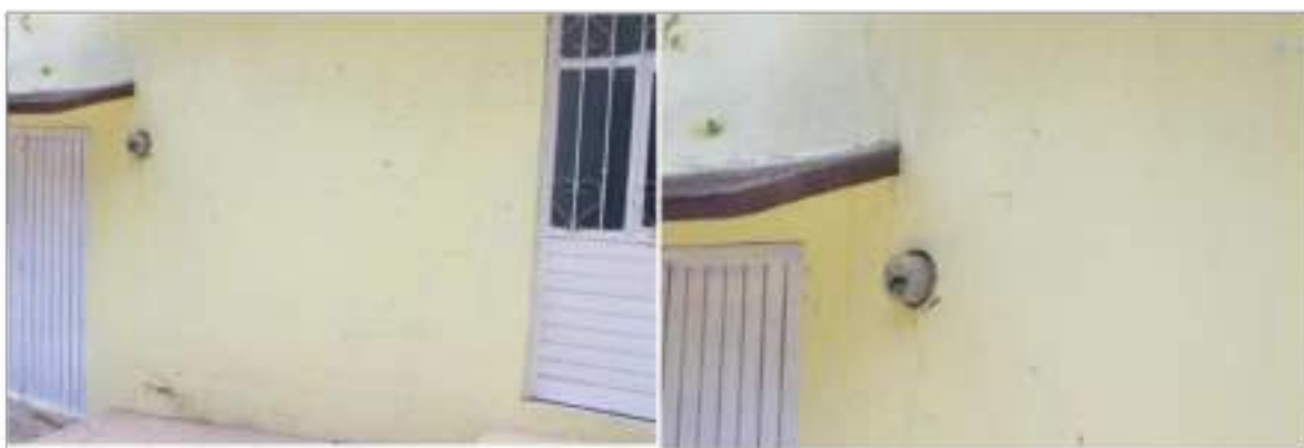
Fotografía 209. Grietas en aplanado en vialidad La Lomita, en Loma Bonita.
