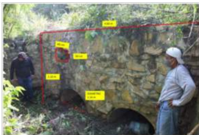
Fotografía 26. Dimensiones del puente de mampostería que cruza el cauce del arroyo con tubos azolvados.
