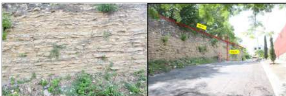
Fotografías 140 y 141. Punto de control (481739, 1847012 UTM), pequeños derrumbes en vialidad producto de los cortes en talud.
