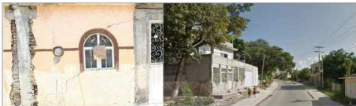
Fotografía 207 (izq). Punto de control 22. Reforzamiento de vivienda que presentaba daños. Fotografía 208 (der.). Punto de control 23. Camino a Pacú; sin evidencias de susceptibilidad al fenómeno de remoción en masa.
