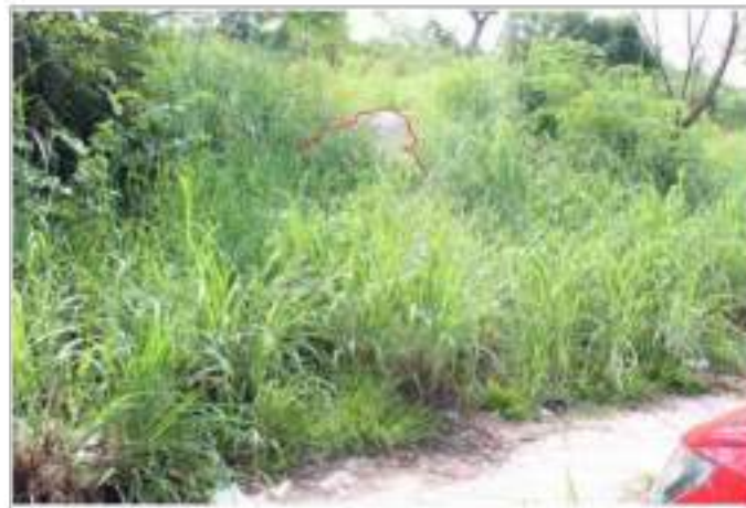
Fotografía 152. Punto de control 14, observamos caídos de roca cercanos a la vialidad del fraccionamiento Chiapas Bicentenario.
