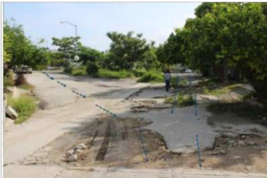
Fotografía 28. Vialidad dañada por los escurrimientos en avenida Jacarandas, esquina Ciruelos en Real del Bosque.
