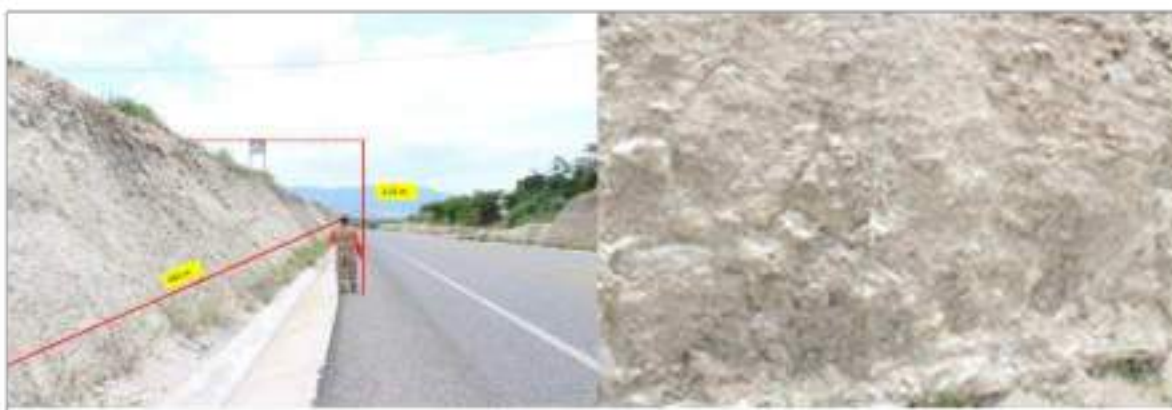
Fotografía 178 (izq.). Talud de vialidad. Fotografía 179 (der.). Materiales finos aplanados.
