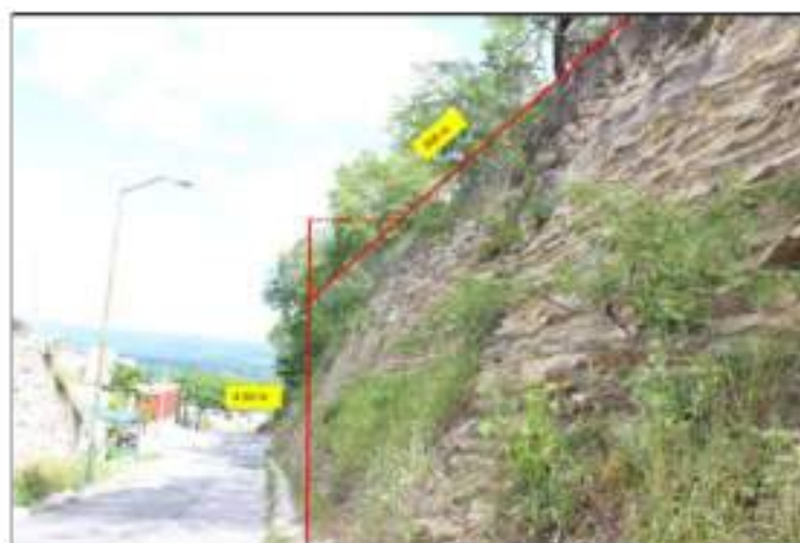
Fotografía 142. Continuación del talud en Calle Los Pirules, fraccionamiento Real del Bosque.
