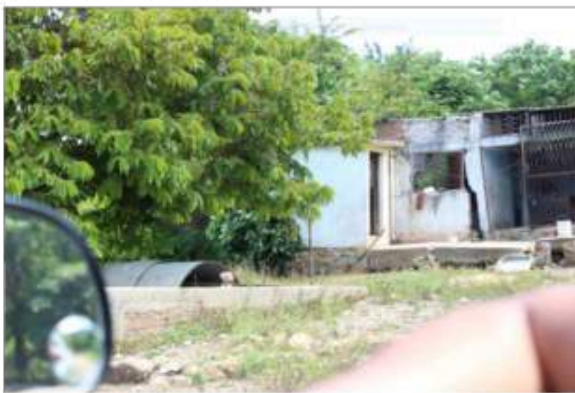
Fotografía 216. Vivienda con daño estructural grave, punto de control 483329, 1849358 UTM.
