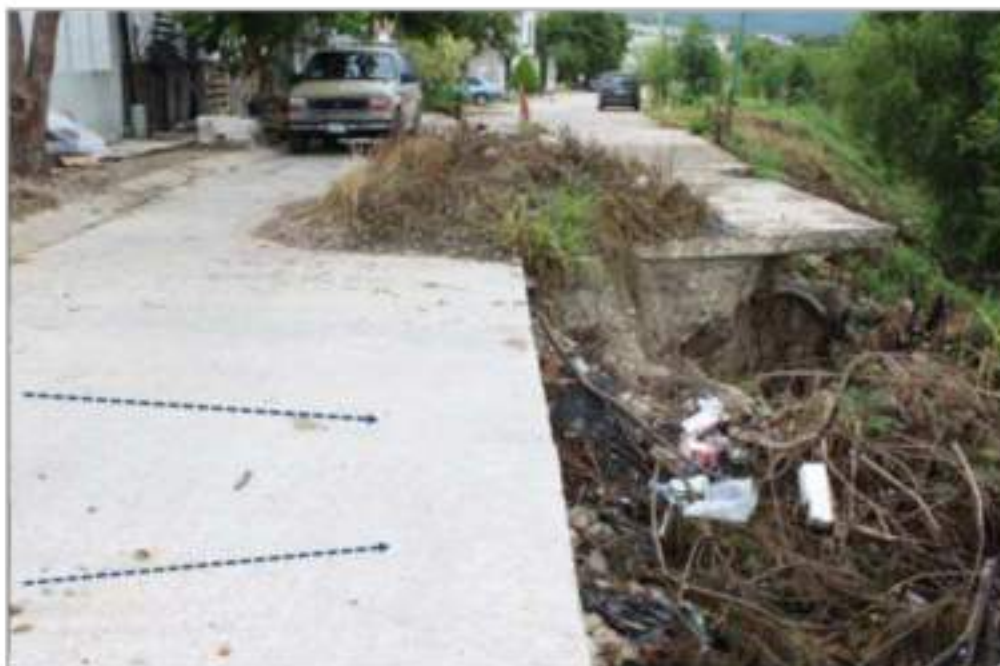
Fotografía 53. Colapso de vialidad, calle las Malvas en Real del Bosque; se observa material de arrastre y los cauces de las escorrentías por la calle.
