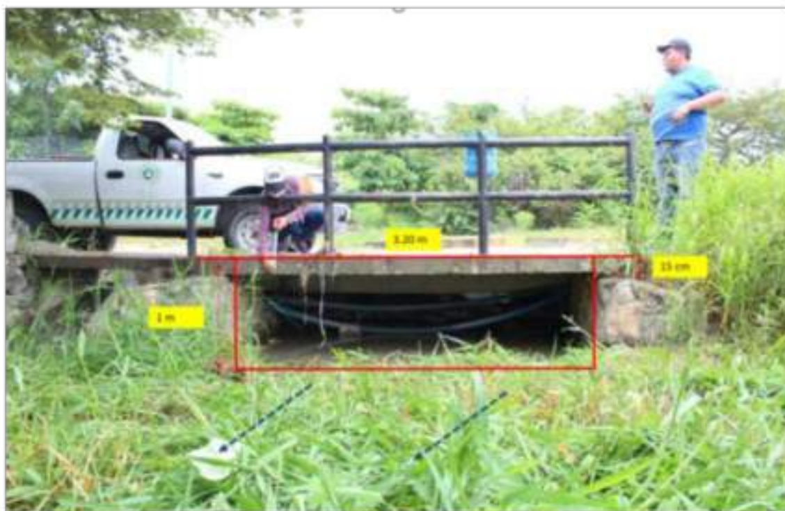
Fotografía 52. Manguera corrugada de polietileno debajo del puente, que atrapa residuos sólidos en temporada de lluvia.
