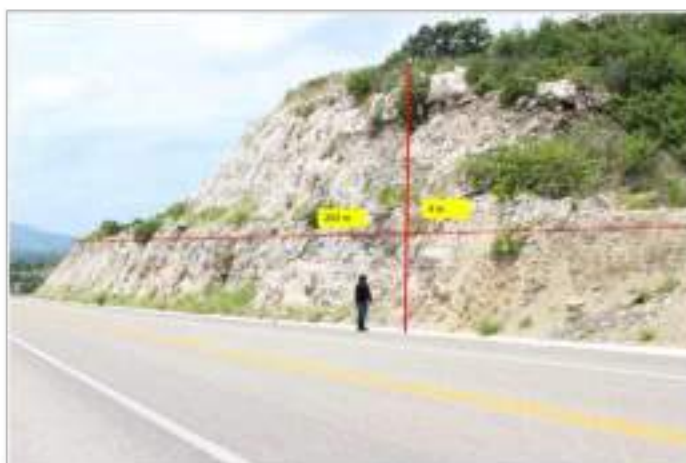
Fotografía 181. Se aprecian caídos en el punto de control 11.
