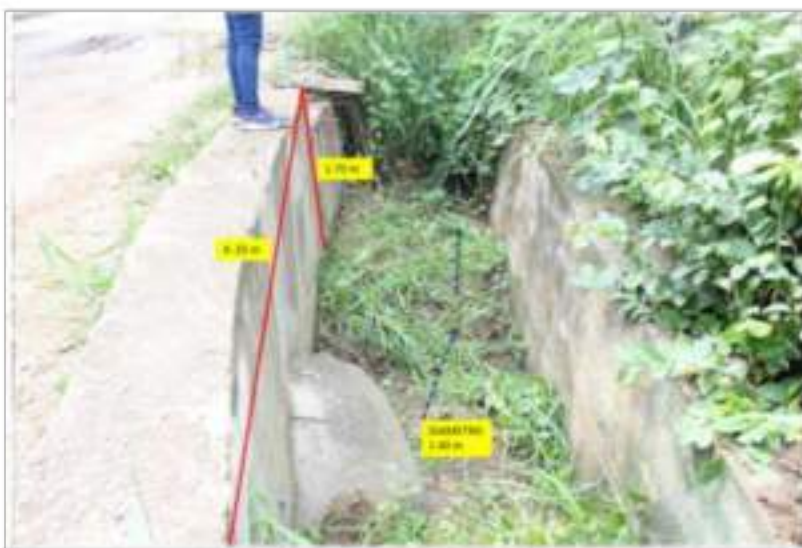
Fotografía 47. Drenaje pluvial por donde fluyen los escurrimientos.
