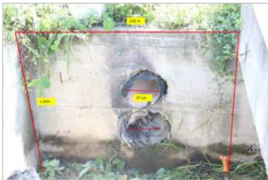
Fotografía 91. Drenaje pluvial con tubos de plástico corrugado, estropeados (481192, 1847550 UTM).
