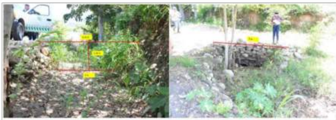
Fotografía 44 (izq.). Puede observarse el cauce natural paralelo a la vialidad de terracería. Fotografía 45 (der.). Se observa el cauce natural rellenado con piedra y tubos de cemento azolvados.
