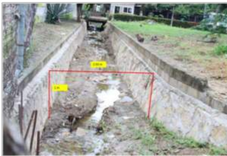
Fotografía 71. Canal pluvial azolvado en la calzada Emiliano Zapata, oficinas del Conejobús.
